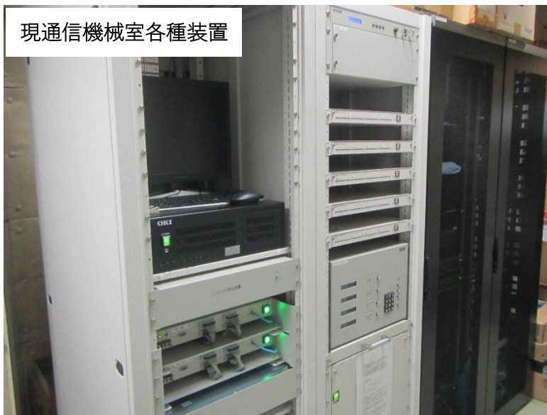
現通信機械室
